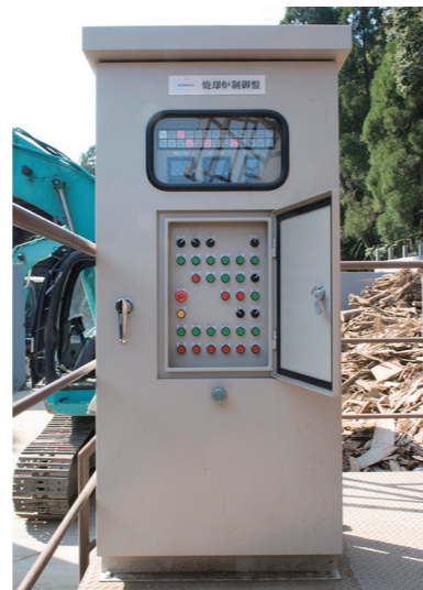
■ 焼却炉操作盤
