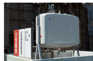
■ オイルタンク
